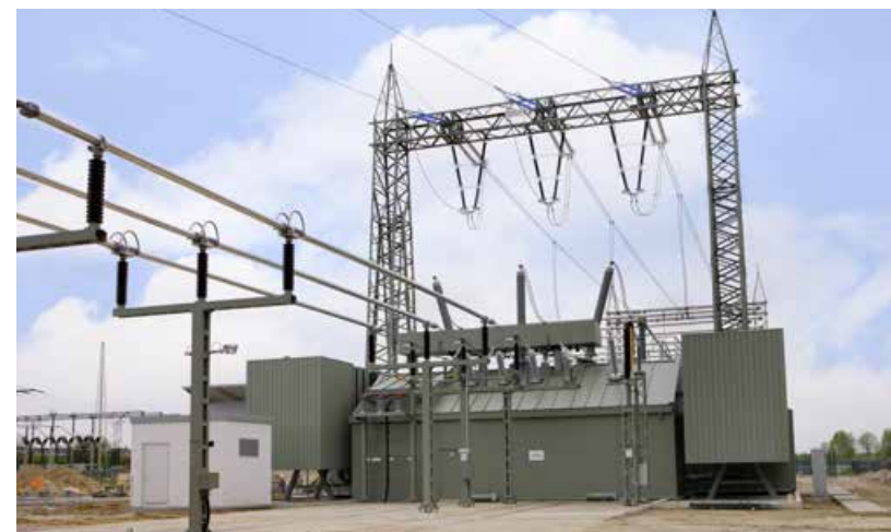
Üblicher 380-/110-kV-Transformator im Umspannwerk
