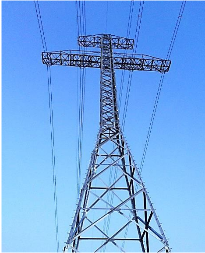
Der Provisoriumsmast im Einsatz.
