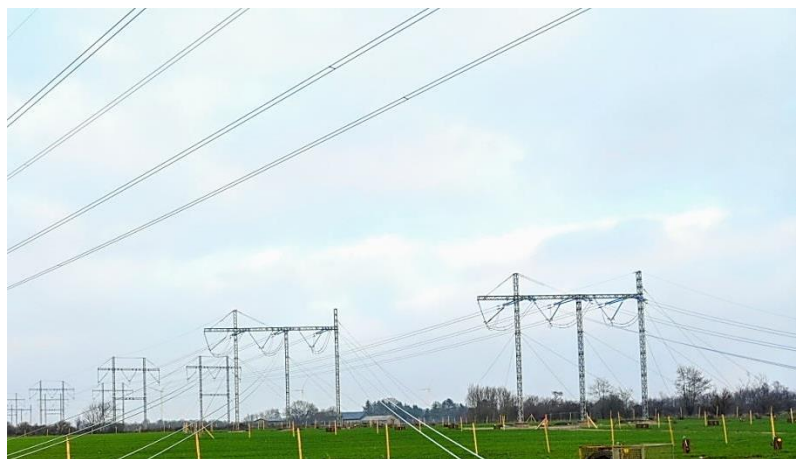
Stahlportale in der Nähe von Schuby
