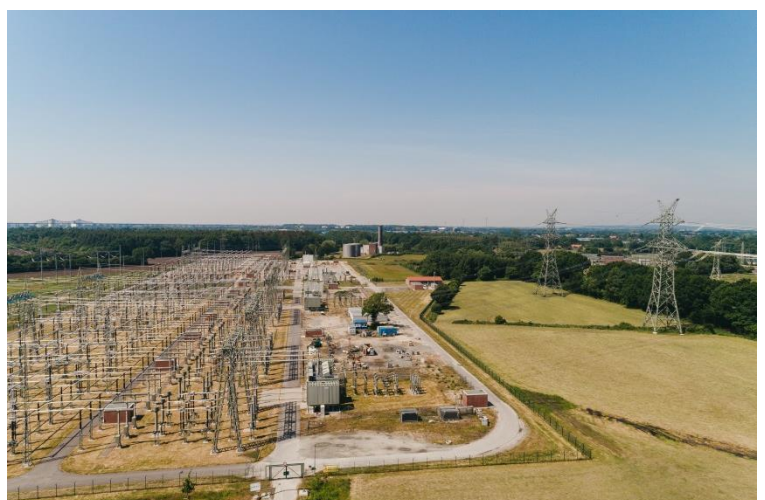
In der gesamten Bauzeit liefen die Arbeiten im Umspannwerk Audorf vollständig unfallfrei ab.
