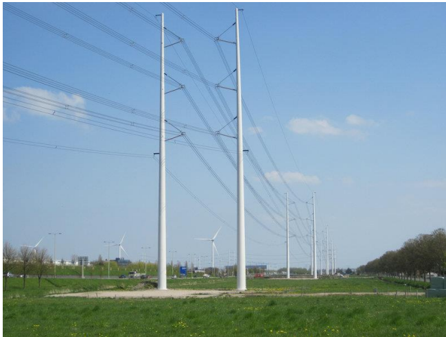
Figuur 1 Wintrack masten
